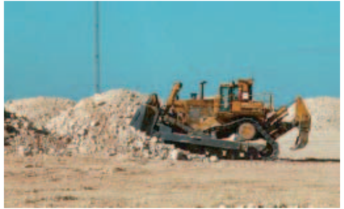
(En haut): Dozer 2000 – la position de l'engin de terrassement par rapport à la surface « théorique » définie s'affiche sur l'écran du conducteur.
